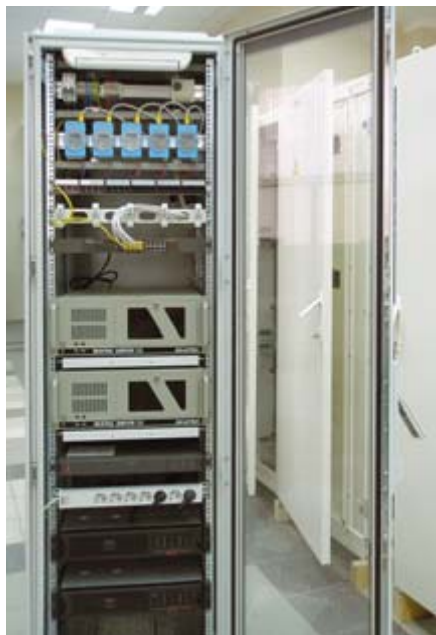
Рис. 4. Общий вид шкафа системы автоматизации вентиляторной градирни
